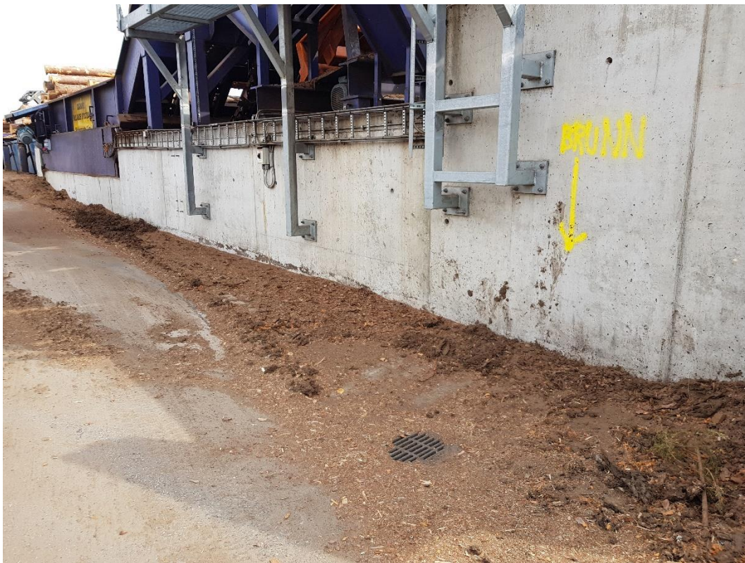
Figur 5. Dagvattenbrunn i den centrala delen av timmerplanen.
