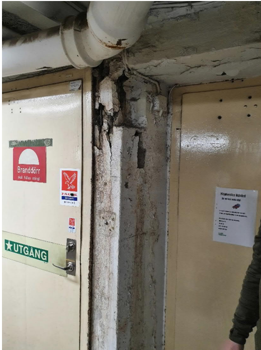
Foto 1 uppsprucken betong i vägg från garage in till höghusdel.
