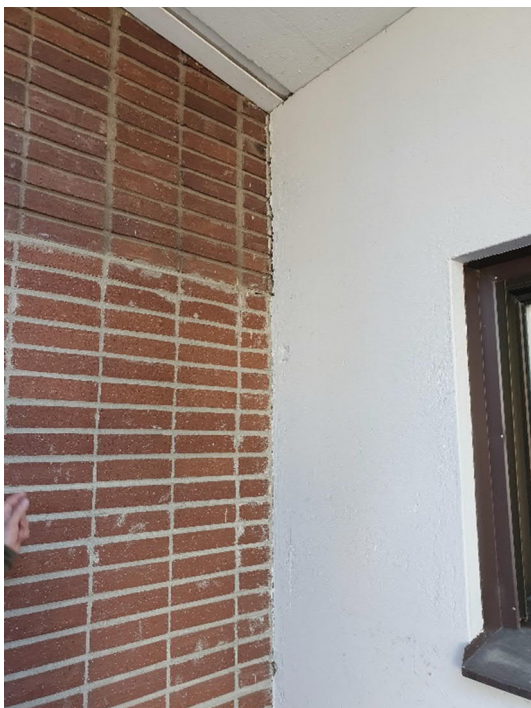
Foto 2 spricka utomhus i vägg mellan garagedel (höger) och höghusdel (vänster).
