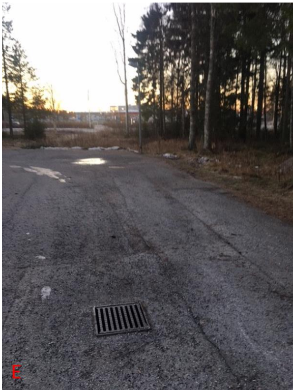
Figur 12. Bild E visar befintlig dagvattenbrunn i vägytan.
