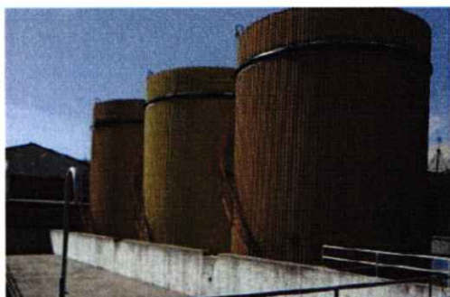
Bild 6. Cisterner för diesel på planen, Älidhems värmeverk.
