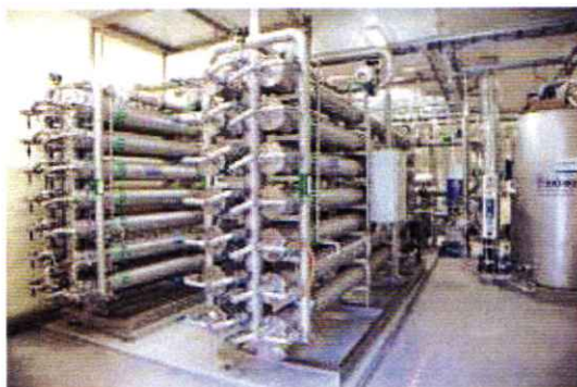
Figur 4.10 Exempelbild på membranfilteranläggning (Källa: Björks Rostfria AB).
