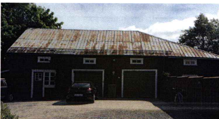
Logens västra fasad med dörr- och fönsteröppning som är väl anpassad till byggnadens karaktär
