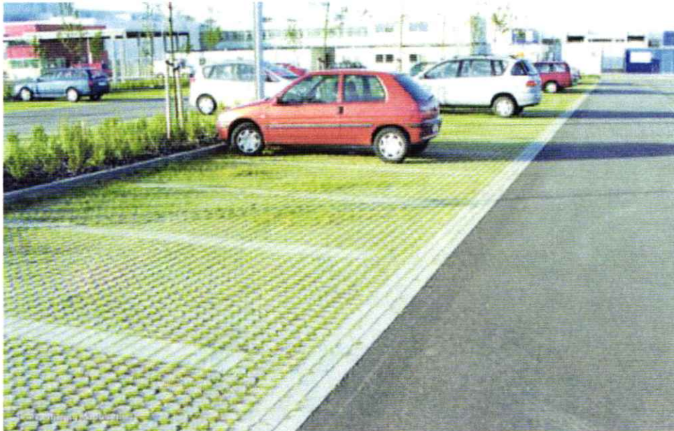
Figur 6:5 Exempel på gräsarmeringssten i parkeringsyta
