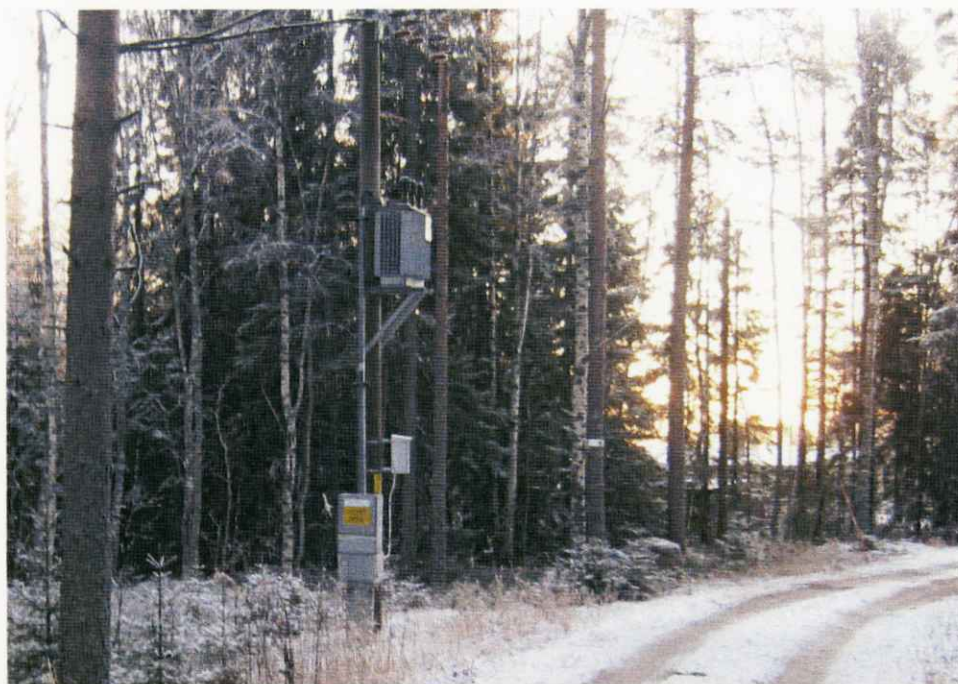
Befintlig transformatorlåda på stolpe
