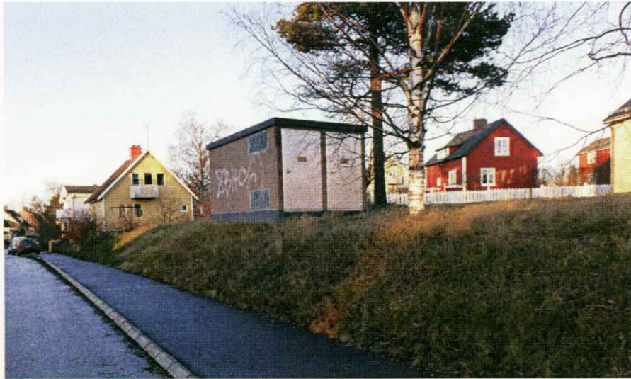
Transformatorstationen sedd från Matrosvägen
